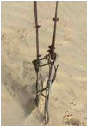
Fig. 47: Rusty guy wire
