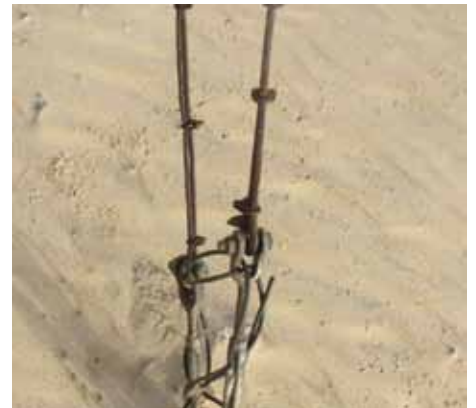
Fig. 65: Rusted guy wire
